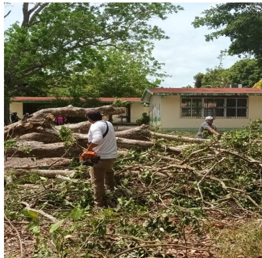
Poda de árboles como una de las medidas de prevención por fuertes vientos.
